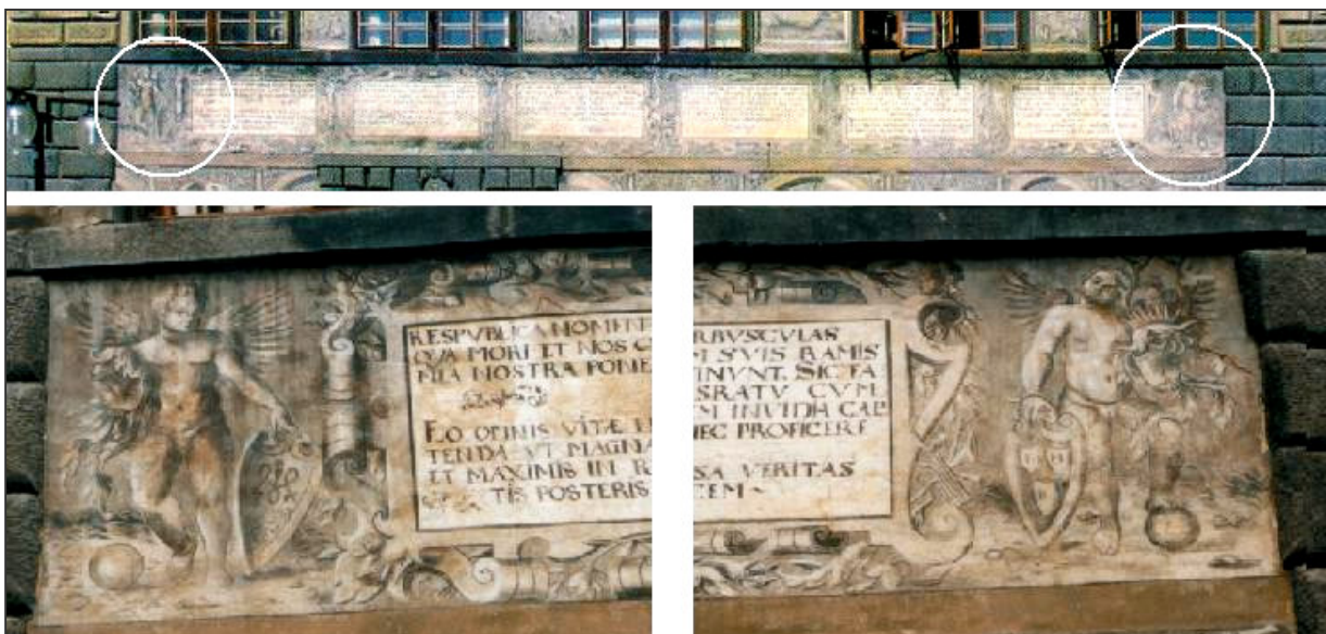
Prachatice, Velké náměstí, budova staré radnice (čp. 1). Detaily výzdoby průčelí. Genius vlevo drží štít se značkou Martina Wolfarta, jeho protějšek vpravo štít s literami IMB. Stav z roku 2002, foto autor.
